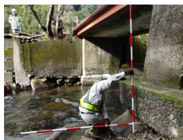
図1.3 損傷区分eの状況写真
