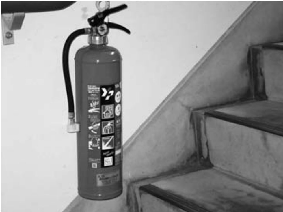
▲町営中層住宅に設置された消火器
