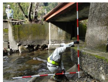
図1.3 損傷区分eの状況写真
