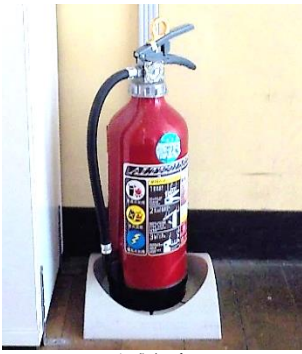
しょうか き 消火器
