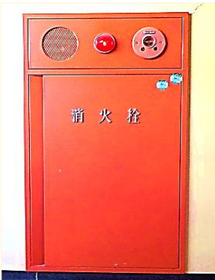
かさいほうち き しょうか 火災報知器・消火せん
