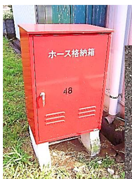
しょうか せん 消火栓ボックス
